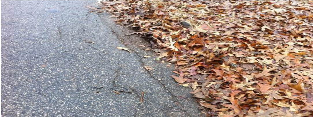
Fig. Edge Cracks
