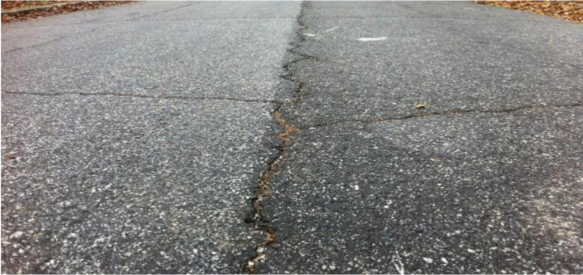
Longitudinal (Linear) Cracking
