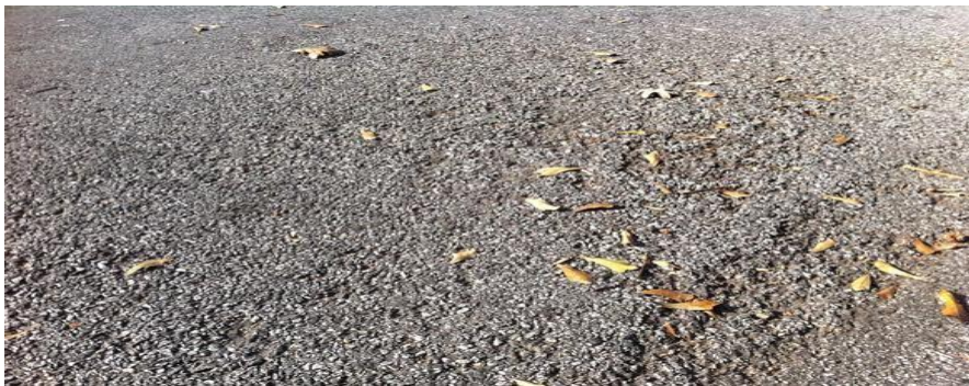
Fig. Raveling (very porous asphalt)
